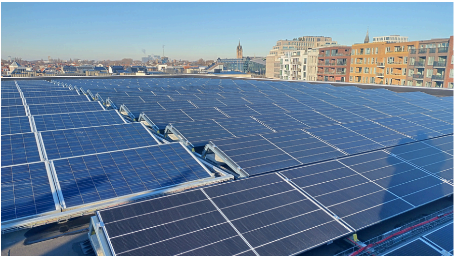
Onze zonnepanelen op SC Delfland naast de panelen van de school zelf
